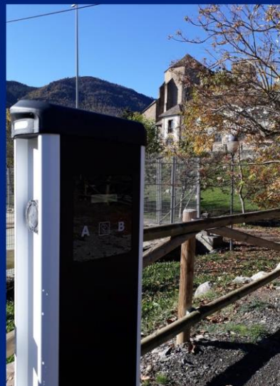
Instalación cargador coches eléctricos, julio 2020
